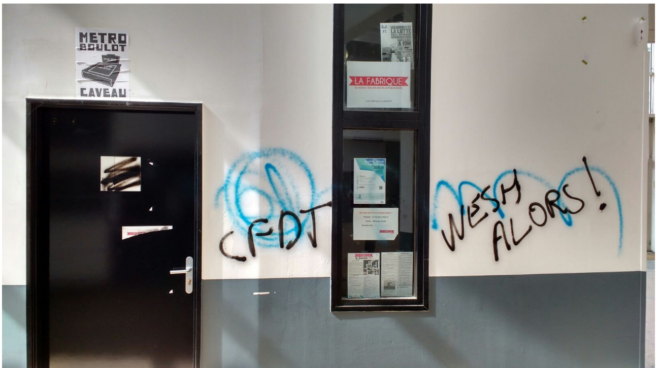
Figure A.3 : Façade tagguée du local de la FABRIQUE
